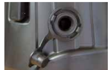
C-Rohr Anschluss für Abwasser
